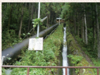
溯区にある水力発電所
